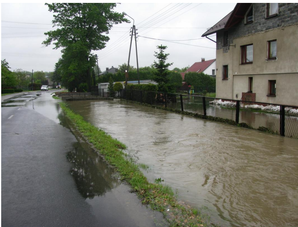
Fot. 14. Ulica Główna – przepust o zbyt małych wymiarach
