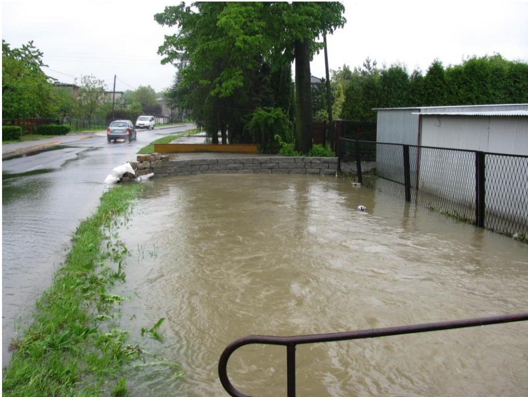
Fot. 15. Ulica Główna – przepust o zbyt małych wymiarach
