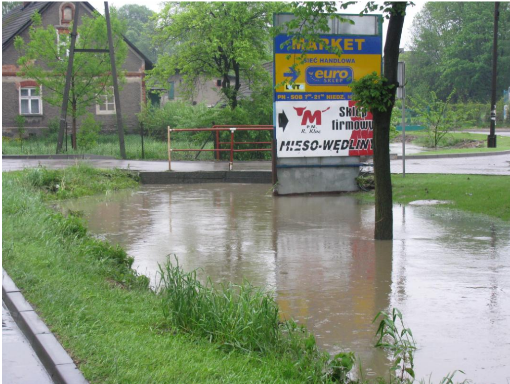
Fot. 7. Ulica Główna – rejon supermarketu EURO – przepust o zbyt małych wymiarach
