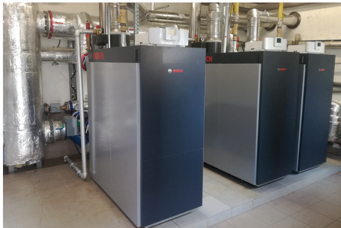
UG ▲ W GOSiR-ze zamontowano nowe kotły gazowe (Fot. GOSiR)
