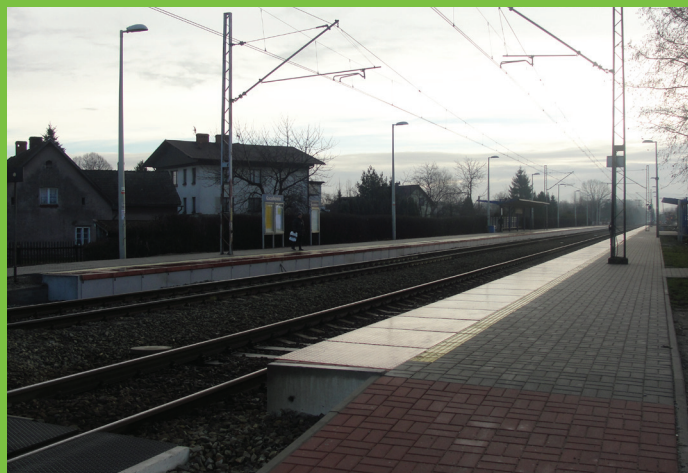
Przebudowa torów kolejowych wraz z peronami – wykonawca: PKP Linie Kolejowe SA Zakład Linii Kolejowych w Sosnowcu.
